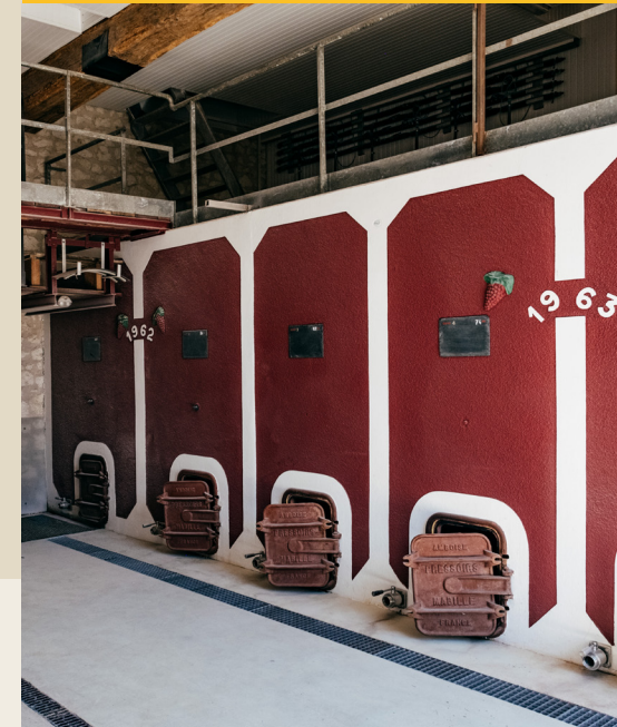
LES CUVES BÉTON
